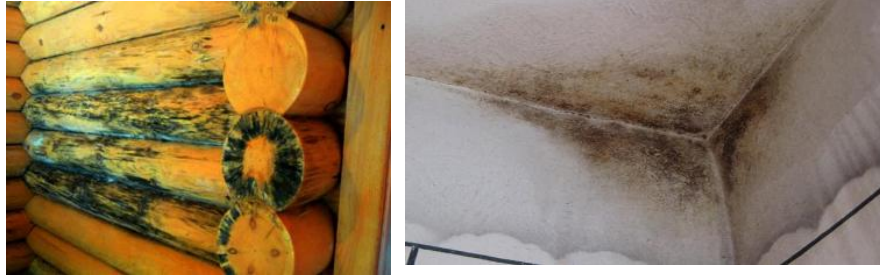
Рис. 6. Ураження грибком дерев'яної та бетонної поверхонь
