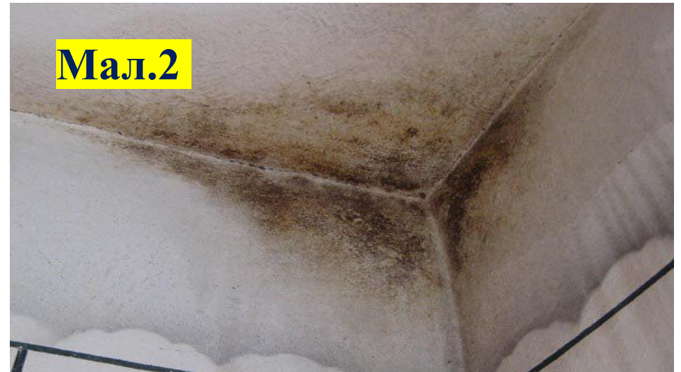
Грибок на бетонній поверхні
