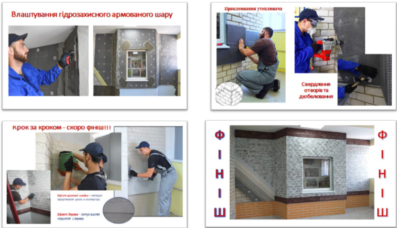
Рис. 2. Участь здобувачів освіти ДПТНЗ «Харківське вище професійне училище будівництва» у проєктах щодо термомодернізації та утеплення будівель
